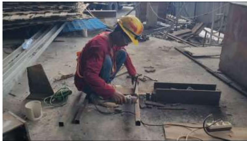
gambar 4. 53 Postur Kerja Pemotongan Besi Hollow Sebelum Dilakukan Perbaikan
