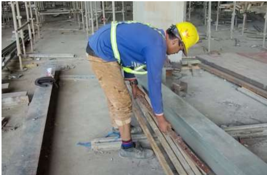
gambar 4. 67. Postur Pengangkatan Material besi hollow Sebelum dilakukan Perbaikan Fasilitas Kerja
