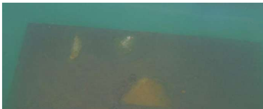
Gambar 4. 45 Hasil Plat sesudah Brushing kondisi Heavy
