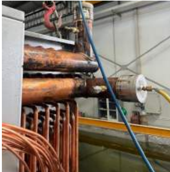
Gambar 2. 2 Unit Kondensor pada Bagian Header
