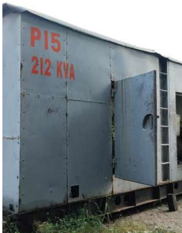
Gambar 2.1 Powerpack Sumber: Dokumentasi Pribadi
