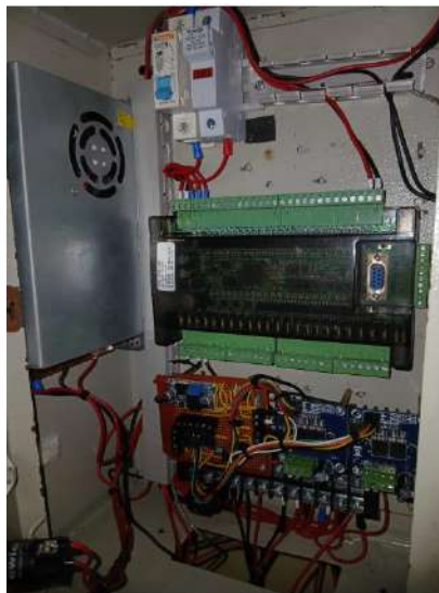
Gambar 4. 8 Wiring pada Panel (Sumber: Dokumentasi Pribadi)
