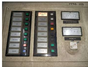
Gambar 4.4 Panel Kontrol Mesin
