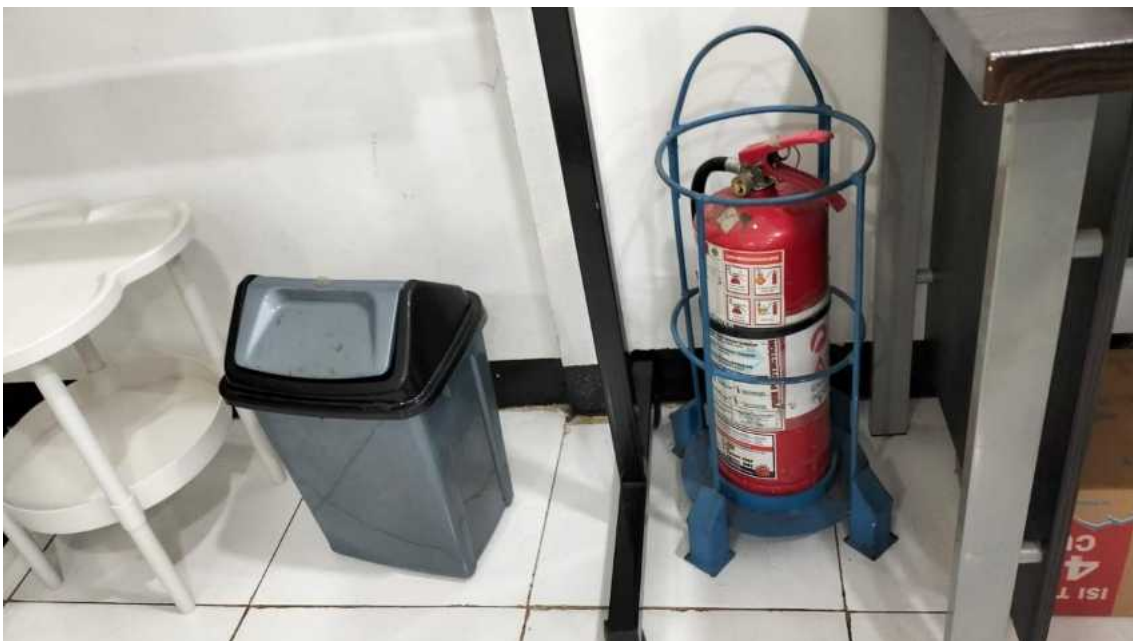
Peletakkan APAR pada area office
