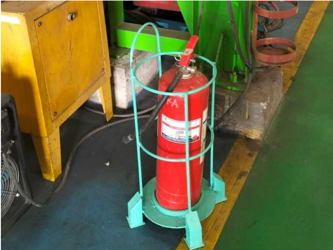
Peletakan APAR pada area workshop
