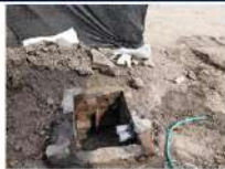
UC – BEFORE : TIDAK ADA PENGAMAN PADA LUBANG BAK KONTROL
