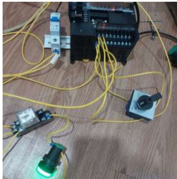
Gambar 4.5 Pengujian Selector Switch dan Pilot Lamp Dokumentasi Pribadi
