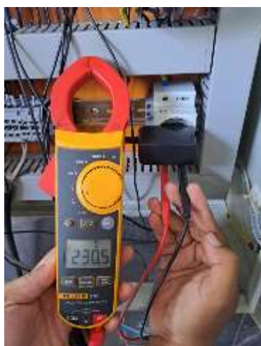
Gambar 4. 3 Pengukuran tegangan L-N dengan Tang Amper
