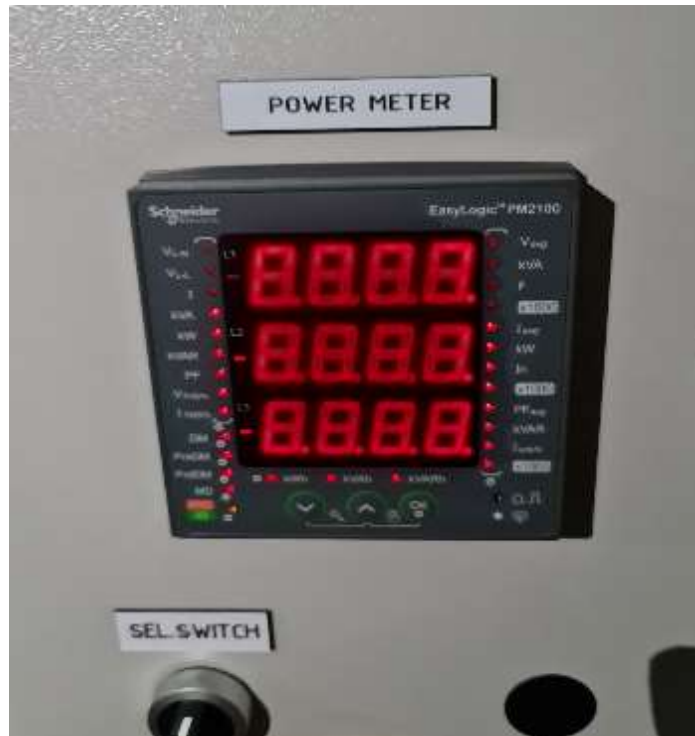
Gambar 4. 4 Power meter saat power 220 Volt dimatikan
