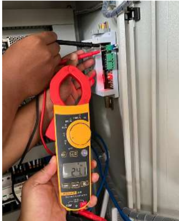
Gambar 4. 1 Pengujian Power Supply Menggunakan Tang Amper
