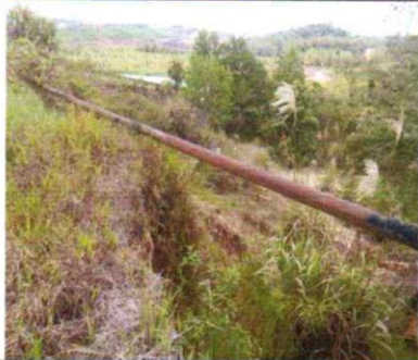
Pada jarak 105 m tidak ada pipe support.
